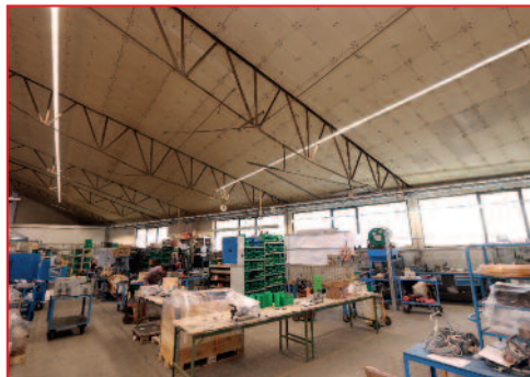
In einem seitlichen Teil der Halle sind die Leuchten auf 3 m Höhe angebracht. Hier entschied man sich für das Philips-Core-Line-Tragschienensystem in der 9.000-Lumen-Variante.
