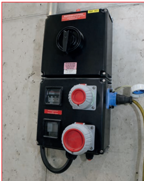
Sicherheit wird in Ex-Bereichen groß geschrieben: Neben der Beleuchtung kam unter anderem auch eine 40 A-Steckdosenverteilung in Ex-Ausführung von Eaton-Cooper-CEAG zum Einsatz.
