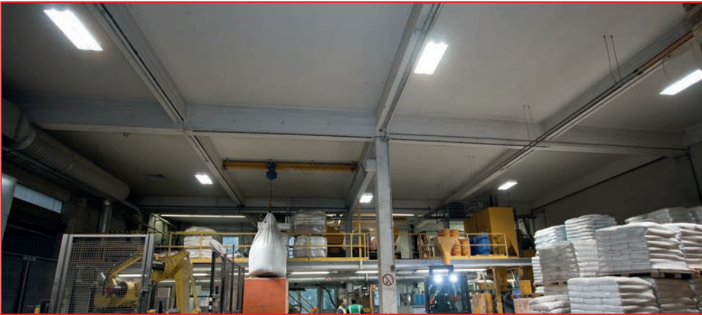
Ausgetrickst: Da die Leuchten auf 5 Meter Höhe montiert wurden, »umgingen« die REGRO-Experten die Forderungen, die Vorschriften für Ex-Zonen nach ÖNORM 8065 einhalten zu müssen, gekonnt und regelgerecht.
